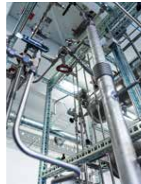
Blick in die HEPP-Anlage (High Efficiency Power-to-Gas Pilot) der Hochschule für Technik Rapperswil
